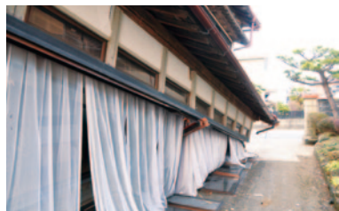
東日本大震災で倒壊した家屋(若柳)
