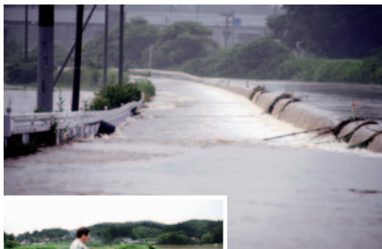
平成 25 年 7 月 堤防沈下による 越流
