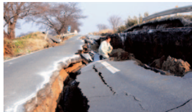
東日本大震災で決壊した堤防(若柳大岡)
